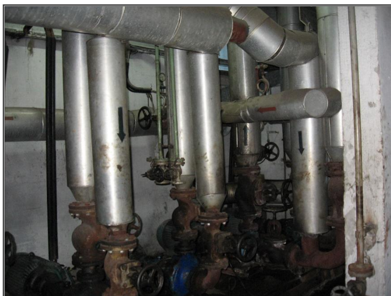
Fotografija 7: Kotlovnica "Z-Blokovi" (Z-16)
