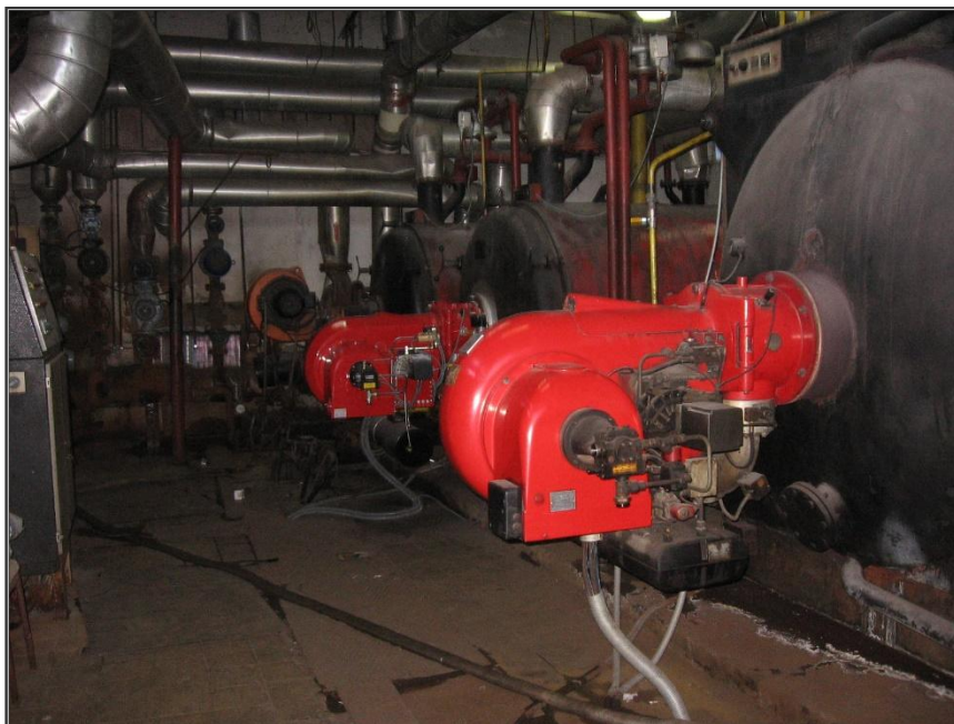
Fotografija 8: Kotlovnica "Zmajevac"
