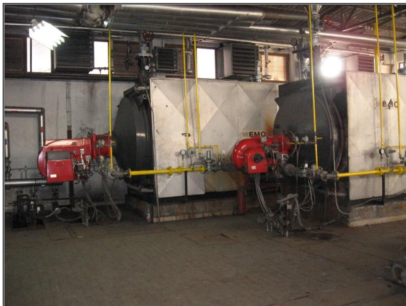
Fotografija 9: Kotlovnica "B-blokovi"
