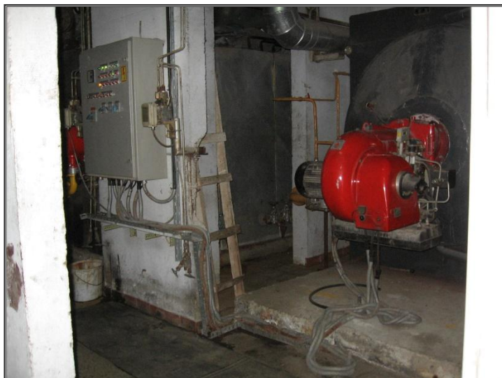
Fotografija 6: Kotlovnica "Z-Blokovi" (Z-16)
