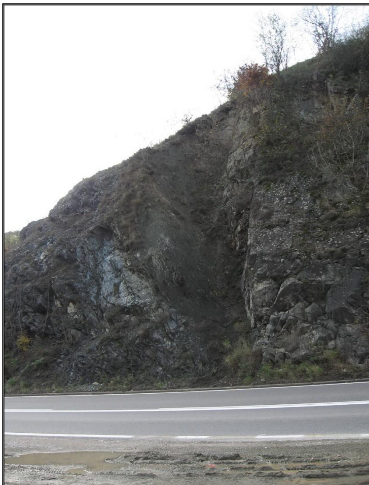
Fotografija 1: Erozija na putu Karakaj – Tuzla
