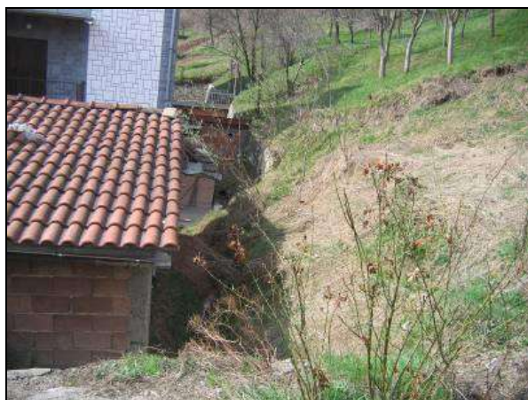
СЛИКА 6. Непланско засијецање падине изградњом објекта (Гробнице)
